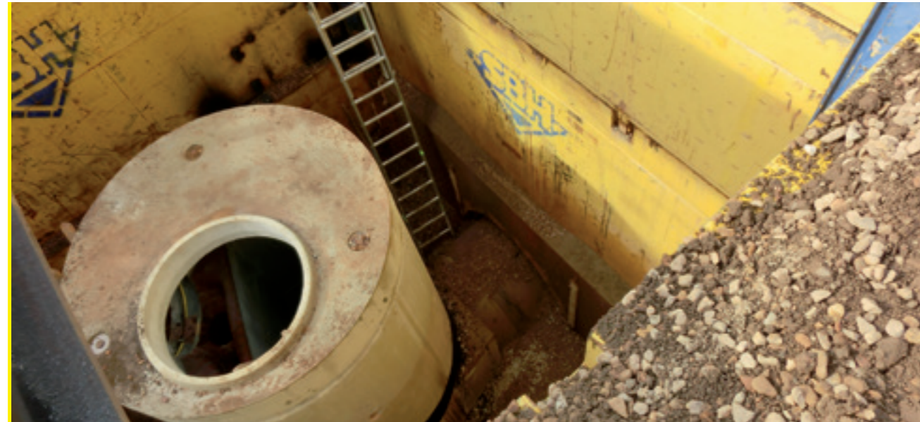
Ein Schacht mit 7,60 m Verbautiefe und Verbauplatten von 7 m Länge. Nach einer Vorhaltezeit von 6 Monaten ist das Ziehen des Verbaus eine zu
